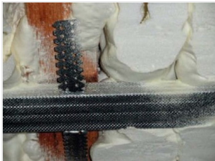
Špatně provedený nástřik, dutiny vedou až k plechovému stropu
