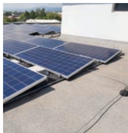
Přetížená konstrukce FVE, pomocí betonových prvků
