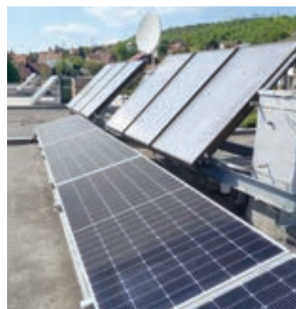
Konstrukce FVE vynesená přes obvodové atiky
