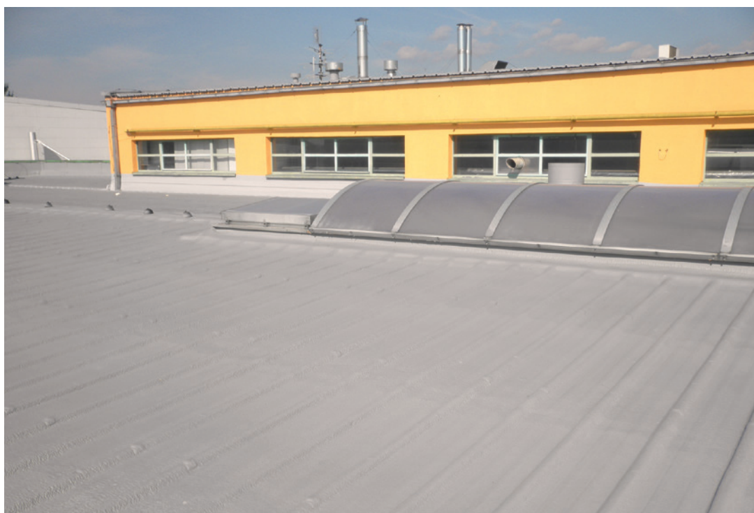
Dobře udělaná střecha nástřikem pur izolace po letech
