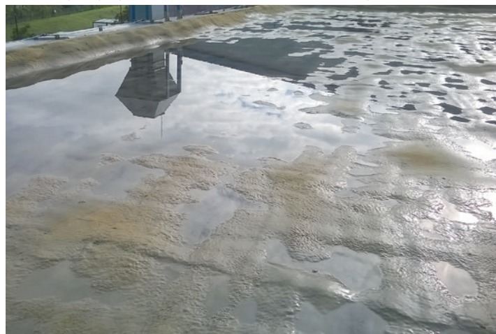
Špatně aplikovaná střešní ekologická pěna
