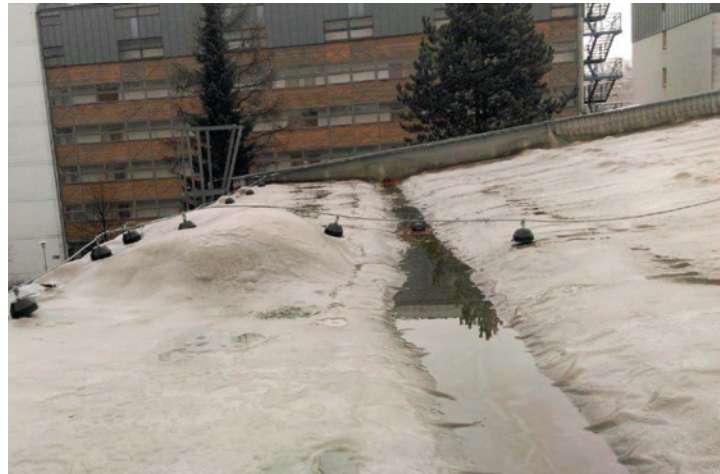
Izolace střechy - tvorba boulí
