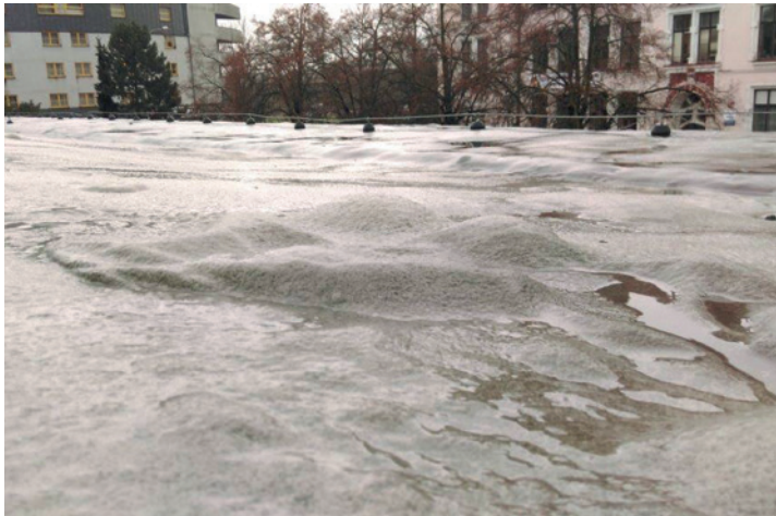
Izolace střechy - nedodržení podmínek
