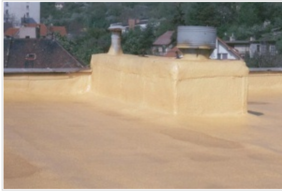
střecha panelového domu izolovaná nástřikem pur, detail nástavby vzduchotechniky, bez UV
