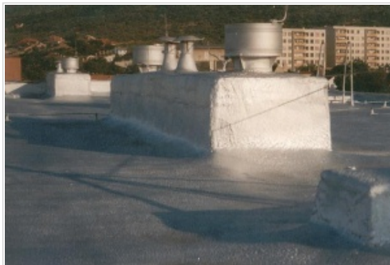
střecha panelového domu izolovaná nástřikem pur, detail nástavby vzduchotechniky, dokončený
