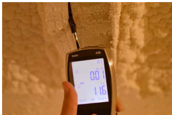
Obrázek /10/ Ve zdánlivé mezeře mezi krokví a tepelnou izolací nedochází při vytvořeném podtlaku k proudění vzduchu (měřená hodnota 0,01 m/s je způsobena nepřesností měřicí metody)
