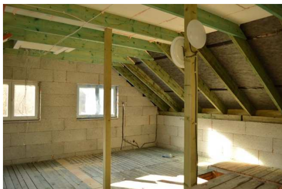
Obrázek /7/ Snímek zateplování podkroví před aplikací (na snímku viditelné množství detailů kolem dřevěných prvků krovu)
