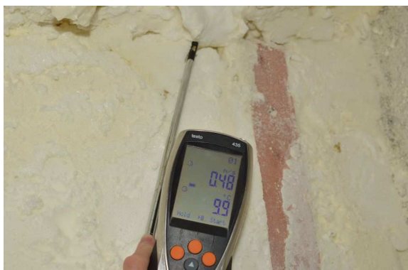
Obrázek /11/ Netěsnost v zateplované konstrukci v detailu napojení střechy a stěny (měřená hodnota proudění vzduchu 0,48 m/s)
