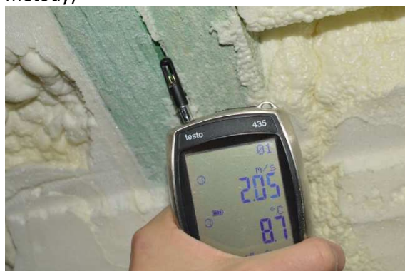
Obrázek /12/ Nalezená netěsnost mezi dvěma dřevěnými kleštinami (měřená hodnota proudění vzduchu 2,05 m/s)
